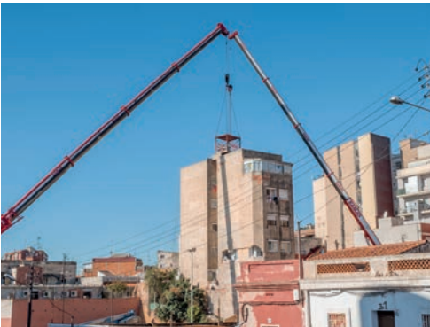
El mal estat d'un edifici al Passatge de la Torre obliga a enderrocar l'edifici i deixa un centenar de desallotjats
