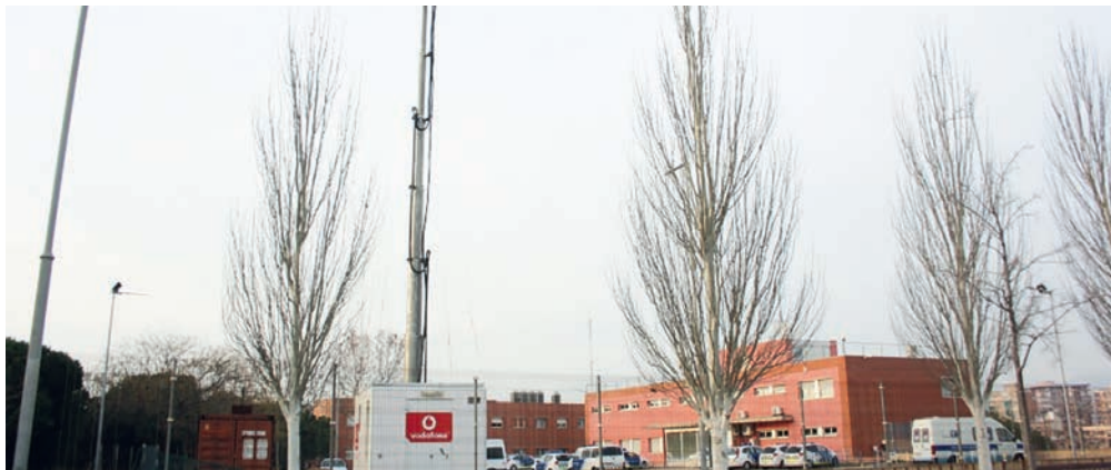
L'antena va estar instal·lada des de l'any 2012 al 2018 a la Comissaria de la Guàrdia Urbana
