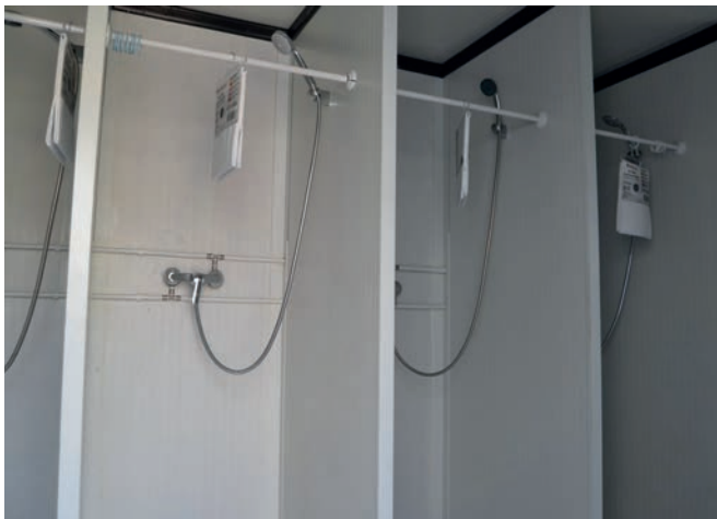
Imatge dels mòduls instal·lats als tres camps de futbol de Badalona
