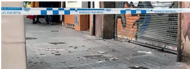
Despreniment de la façana, ara fa uns mesos
