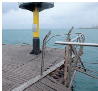
Imatge dels desperfectes al Pont del Petroli
