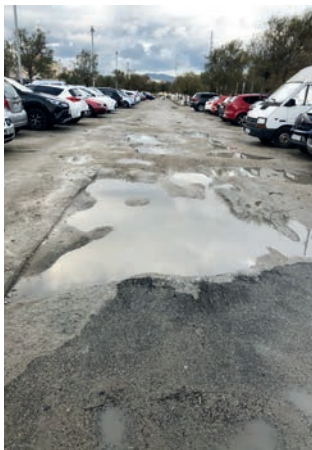
Estat de l'aparcament de Renfe, aquesta setmana. Foto: Albert Guerra
